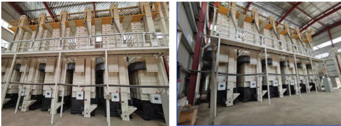
空气源热泵粮食干燥装备应用于于都县现场图
